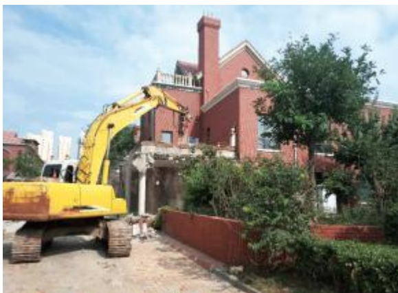
治理双新街昆芳苑小区违法圈占行为（区综合执法局提供）
