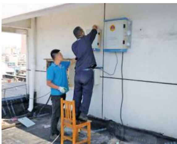
对警报设备进行维护检修（车长月提供）
